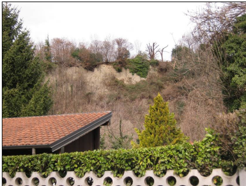
Figura 4.9 scarpate a instabilità superficiale diffusa presso loc. Roccolo
