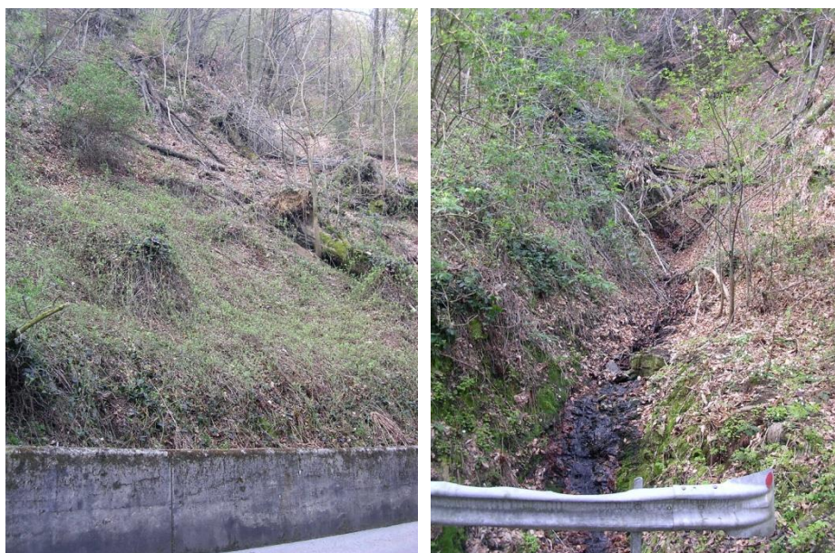
Foto sx.: area in dissesto a monte di via Biviglione, nelle vicinanze della omonima località. La foto evidenzia la presenza di numerose piante abbattute. Foto dx: uno degli impluvi intersecanti la strada, potenzialmente soggetto al trasporto di detriti sul manto stradale. Numerose piante morte occludono parzialmente l'alveo del ruscello - 2013
